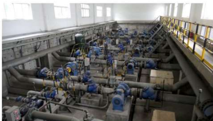
造循环水泵房（工业冷却）
